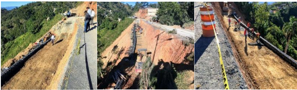
Supervisión avances construcción de carretera Los Montancitos-Los Fríos, en San Juan de la Maguana.
