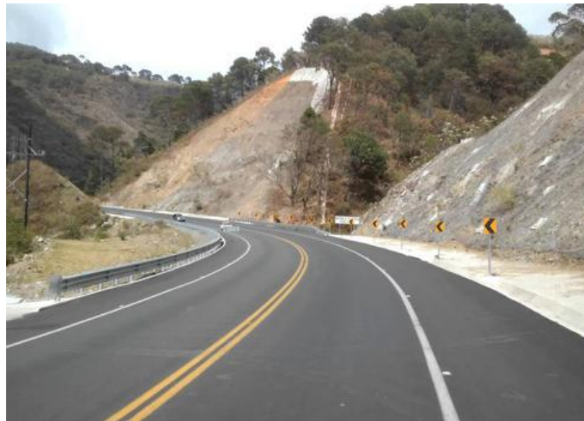
CONSTRUCCIÓN Y RECONSTRUCCIÓN OBRAS VIALES, CALLES , ACERA, CONTENES, DE LAS PROVINCIAS SAN CRISTÓBAL, PERAVIA, SAN JOSÉ DE OCOA, AZUA, SAN JUAN, ELÍAS PIÑA, BARAHONA, BAHORUCO, PEDERNALES, INDEPENDENCIA, ESPAILLAT, SALCEDO, SANTIAGO, MARIA TRINIDAD SÁNCHEZ.
