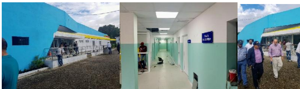
Supervisión hospital de El Mamey, Los Hidalgos, Puerto Plata, a punto de concluir su intervención.
