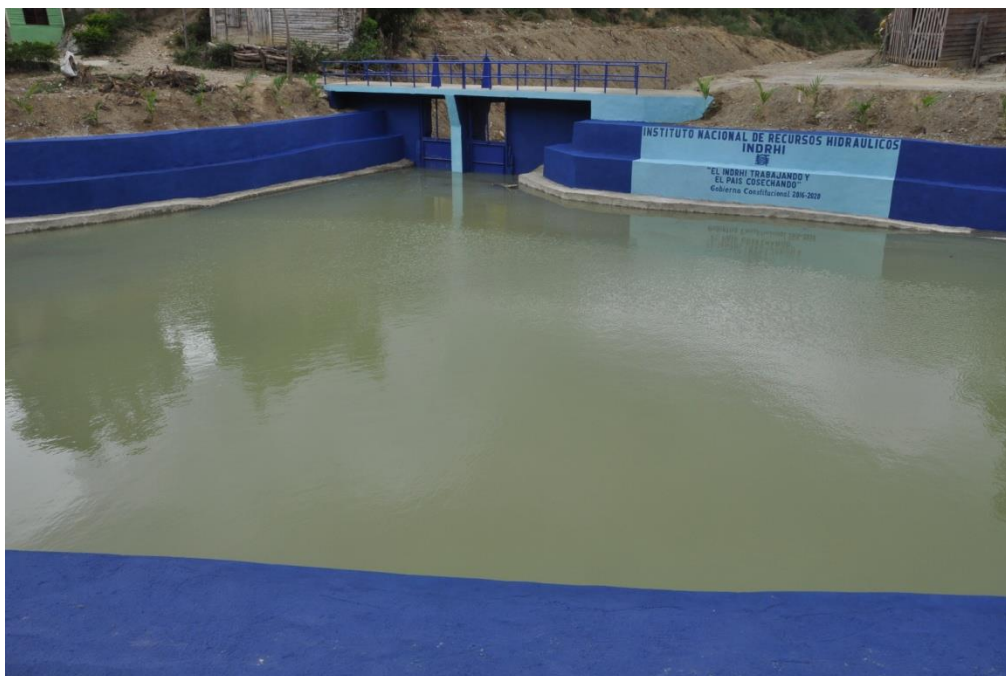
Muro de gavión río Las Cayas, Laguna Salada, Valverde
