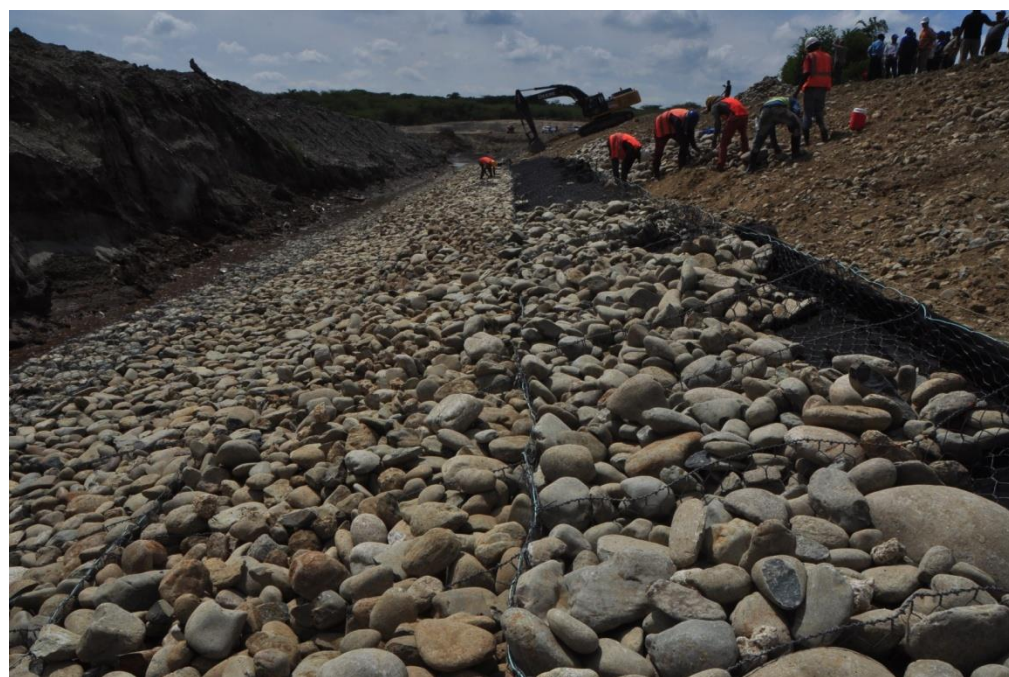
Muro de gaviones de protección al río Yaque del Norte, Esperanza, Valverde
