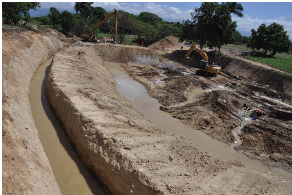
Dique Proyecto Río Yabano, Cuenda, San Juan
