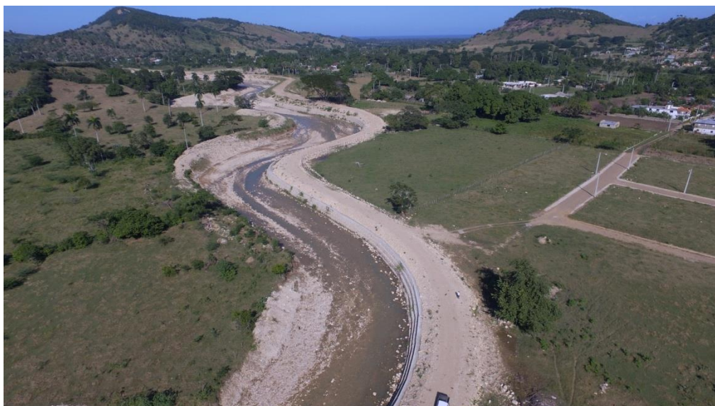
Muro de gaviones río Gualetico, Villa Isabela, Puerto Plata
