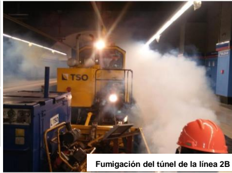
Fumigación de las instalaciones de la Línea 2B del Metro de Santo Domingo.
