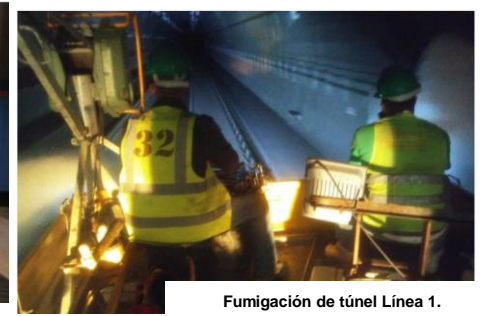
Fumigación de túnel Línea 1.
