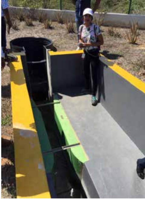
Medidor de flujo Parshall
