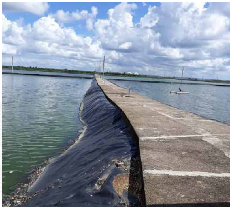
Laguna de Oxidación
