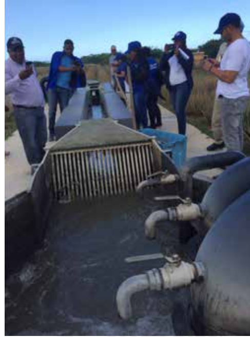
Pre-tratamiento: Rejillas de desbaste
