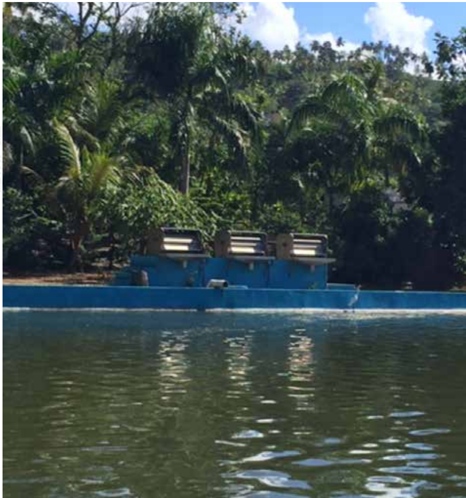
Pre-tratamiento y laguna de aireación.
