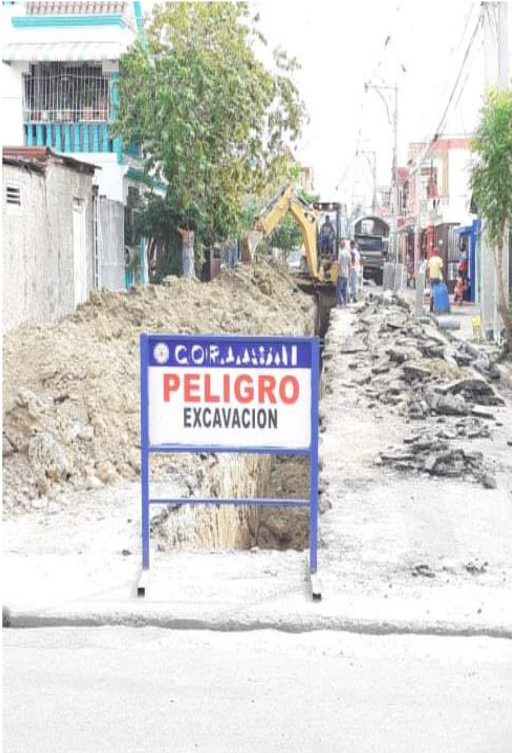
Sustitución de 40 mts. de tubería de 8" H.S. en C/3 de Buenos Aires
