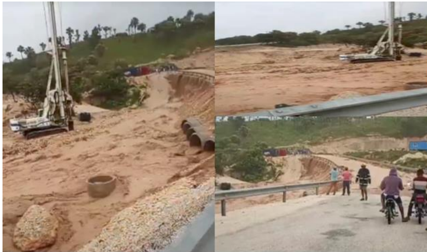
Imágenes: 18,19 y 20, muestran Colapso de puente que conecta pedernales y Barahona próximo al balneario de Los Patos el día 3 de julio.
