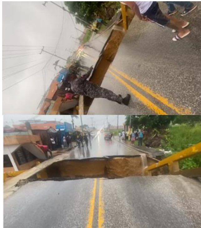
Imágenes: 34 y 35, Colapsa Puente que comunica la Seiba y Nisibón, por lluvias registradas desde el 26 al 30 de octubre- provincia la Altgracia.
