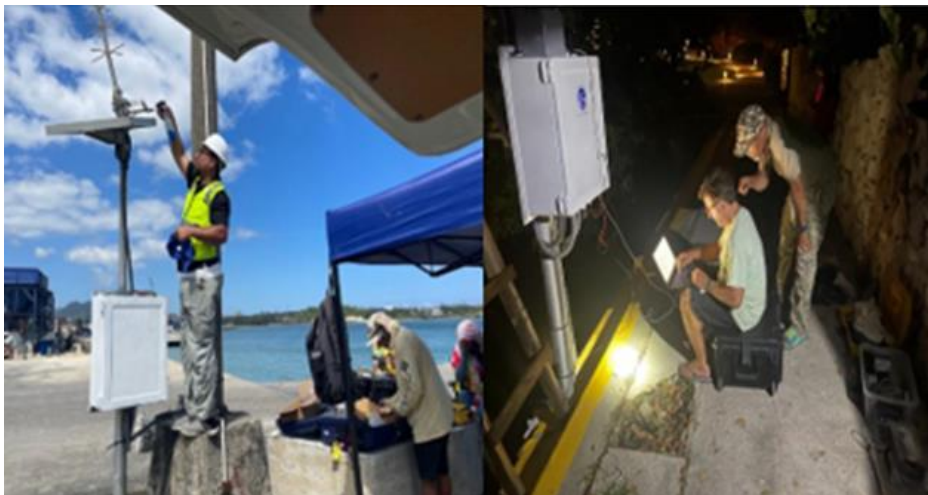
Imagen 30: Mantenimiento a mareógrafos.
