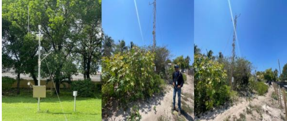
Imagen 31: Instalación de una estación meteorológica automática en la sede de ONAMET, emplazamiento de la isla Saona.
