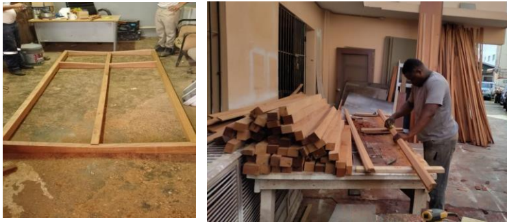
Trabajos de ebanistería en el taller para puerta- ventanas Cúpula. Fuente: División de Mantenimiento Civil.
