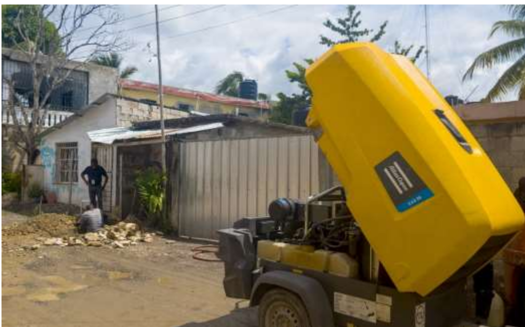
Acometida Domiciliaria de Agua Potable
