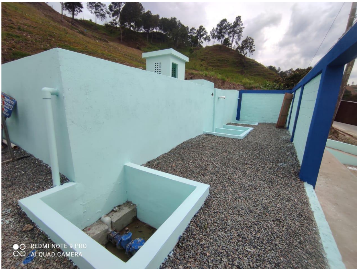
Evidencia 1. Tanque del Río Constanza — vista interna/área de válvulas y componentes (Constanza).
