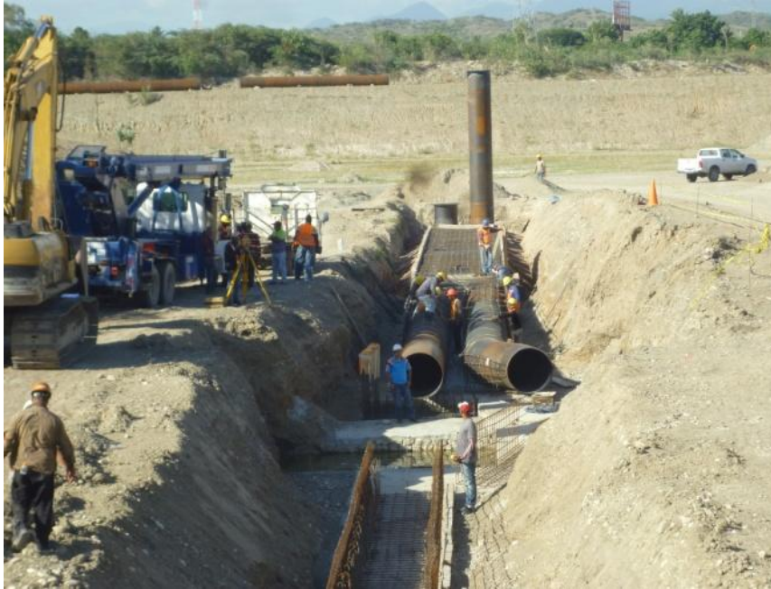
Tubería de salida laguna No 1
